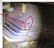
2号機 ボイラ配管損傷箇所
